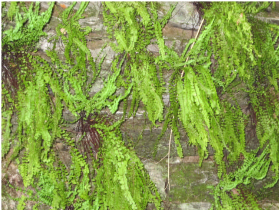
Farnbewuchs an den Wänden der Brunnenkammer
